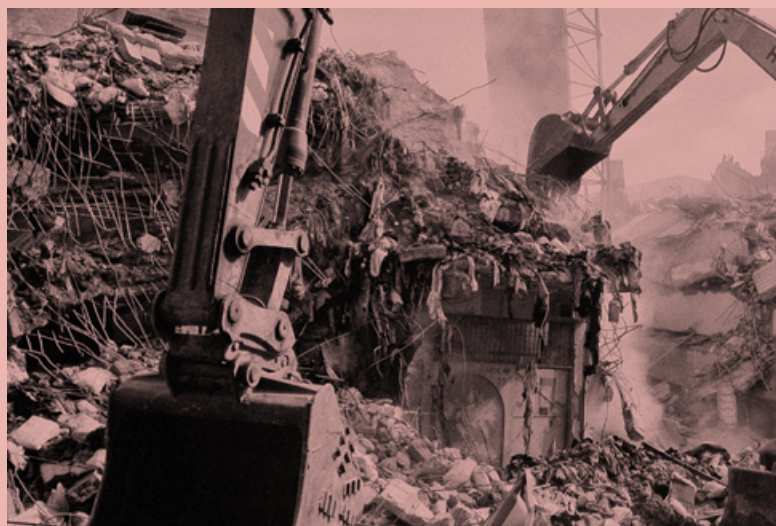
Die ausgebrannte Textilfabrik wurde abgerissen, doch die Fragen, die durch diese Katastrophe ausgelöst wurden, lassen sich nicht mehr aus der Welt schaffen. ©HBWWF (Home-Based Women Worker's Federation)
